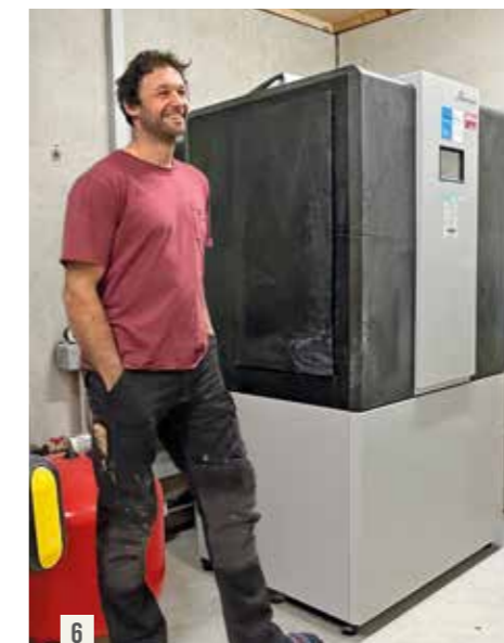
[6] Hausherr Max Dünßer ist Architekt und hat das Haus Blässe selbst entworfen. Geheizt wird hier mit der Luftwärmepumpe MOZART81-RW50 von BÖSCH für die Innenaufstellung.
